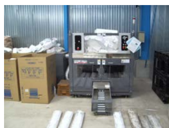
発泡スチロール溶融設備 処理能力：400kg/h
