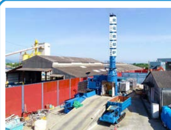
サーマルリサイクル 発電焼却炉
